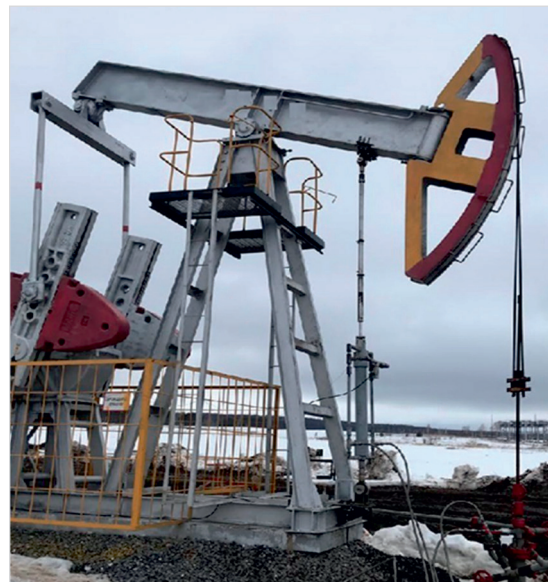
Фото 2. Компрессор скважинный, установленный на скважине
