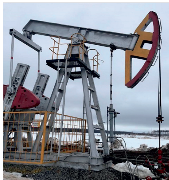
Фото 2. Компрессор скважинный, установленный на скважине
