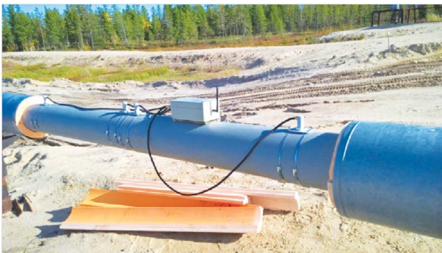
Рис. 2 — Фото регистратора, установленного на коллекторе Губкинского куста скважин №35 при снятых элементах теплоизоляционного слоя
