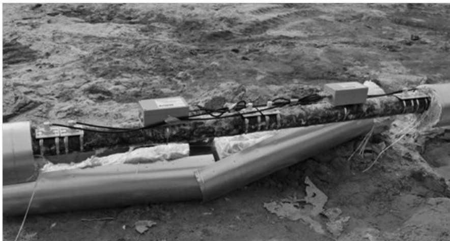
Рис. 1 — Две системы «КАДЕТ», установленные на шлейфе одной из скважин Ямсовейского месторождения ООО «Газпром добыча Надым»
