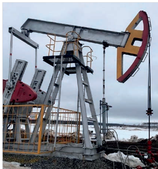
Фото 2. Компрессор скважинный, установленный на скважине
