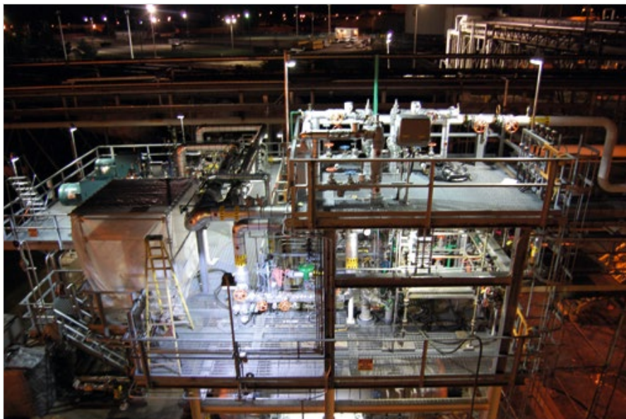
Рис. 1 — Использование светодиодных светильников на нефтеперерабатывающем заводе обеспечило высокое качество освещения при минимальном рассеянии света
