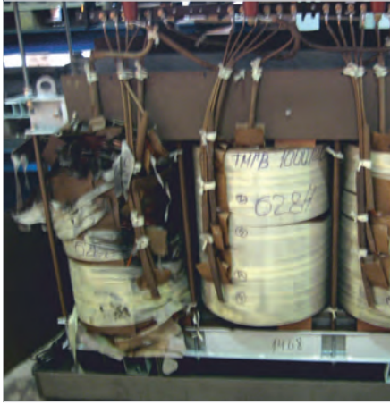
Рис. 2. Поврежденный трансформатор с дефектами обмоток и изоляции Fig. 2 – Damaged transformer with faults in windings and its insulation
