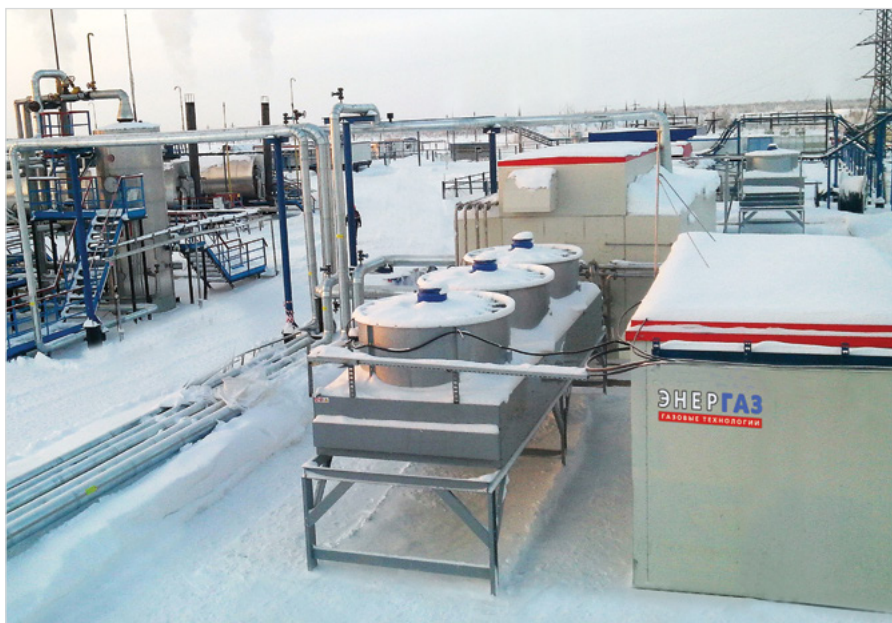
Фото 1. Система подготовки попутного газа на ЦПС Западно-Могутлорского месторождения
