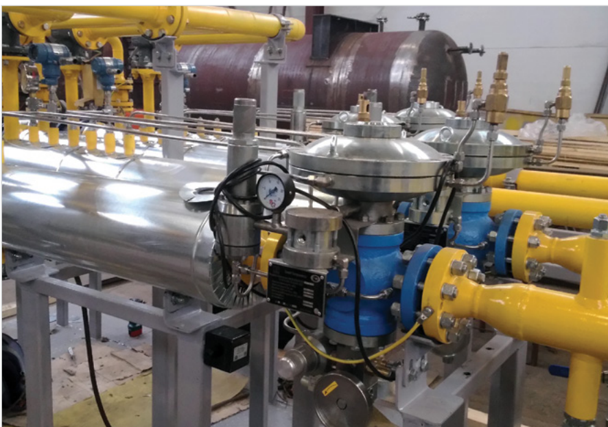
Фото 5. Линии редуцирования в составе СПТПГ для ДКС месторождения «Алан»
