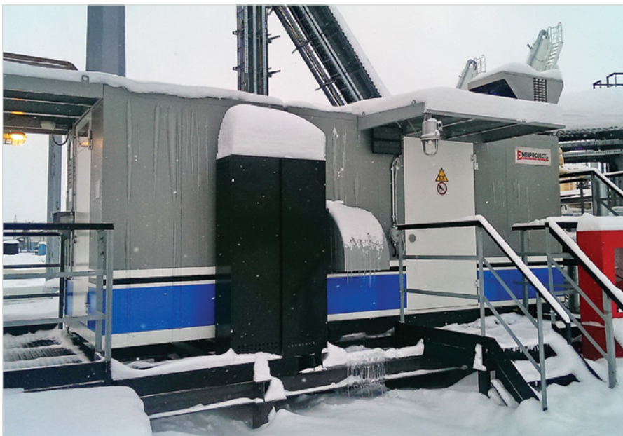
Фото 3. Вакуумная компрессорная станция на УПСВ-9 Советского месторождения
