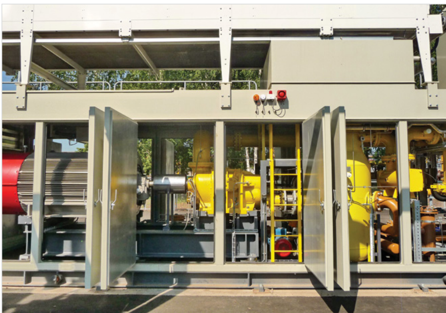
Фото 8. Модернизированная газовая компрессорная установка для ПГУ-60 Уфимской ТЭЦ-2
