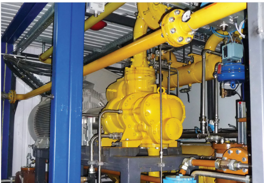
Фото 7. Газодожимное оборудование в основе УПТГ для ГТЭС Верх-Тарского месторождения
