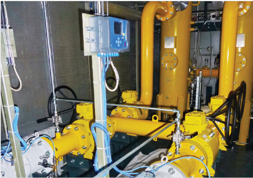
Фото 4. БПТГ в составе системы газоподготовки на ГТЭС-25 завода Kastamonu
