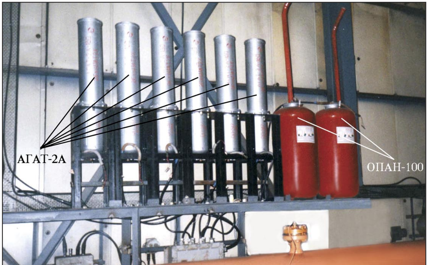
Рис. 2. Комбинированная защита газокomppressorной станции «SOBERROW-182» модулями ОПАН-100 и аэрозольными генераторами АГАТ-2А
