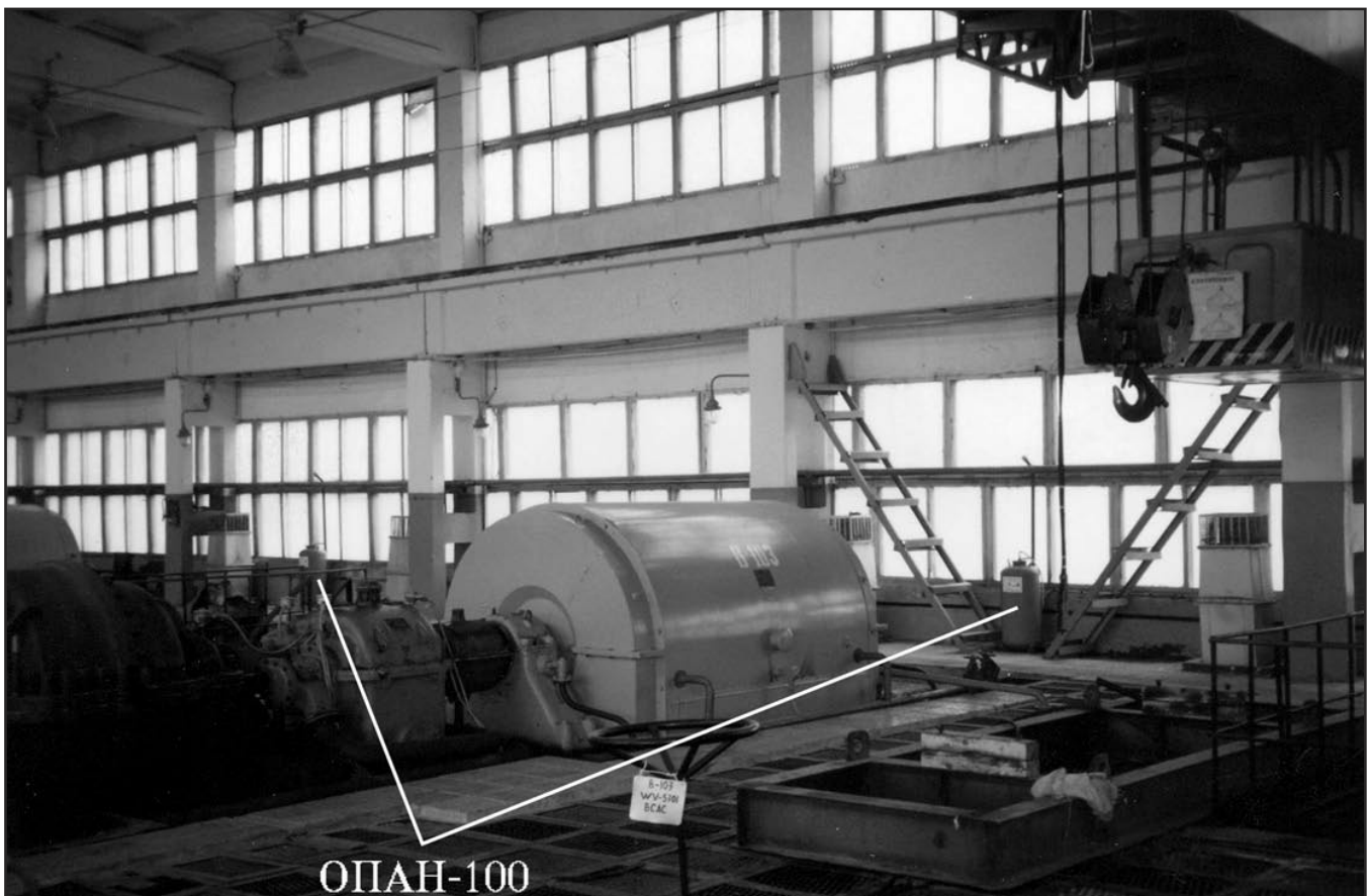
Рис. 1. Защита компрессорного цеха завода «Пермнефтегазпереработка» модулями ОПАН-100
