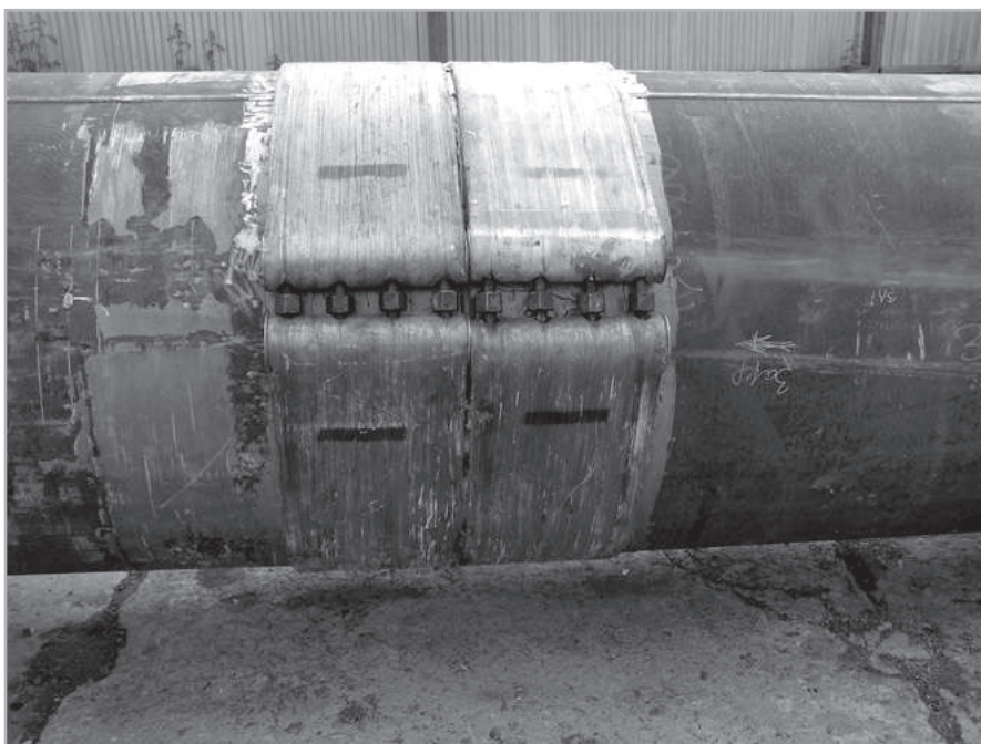
Рис. 1. Трубный образец с двумя вплотную установленными муфтами
