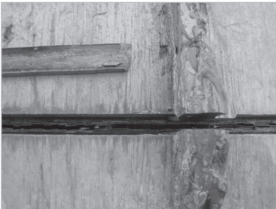
Рис. 2. Сквозная трещина и выпавший из дефекта фрагмент заполимеризовавшегося заполнителя после демонтажа муфт
