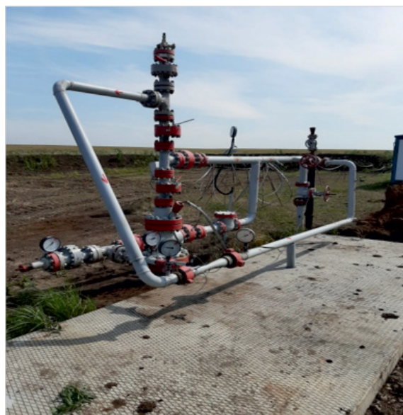
Фото 1. УСУ в устьевой обвязке скважины
