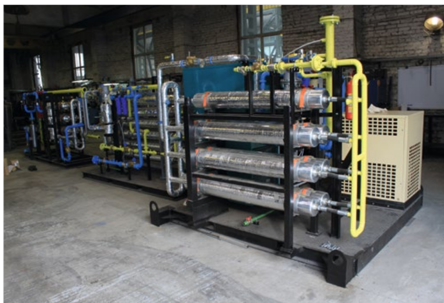
Рис. 3 — АМУ (Азотная мембранная установка)
