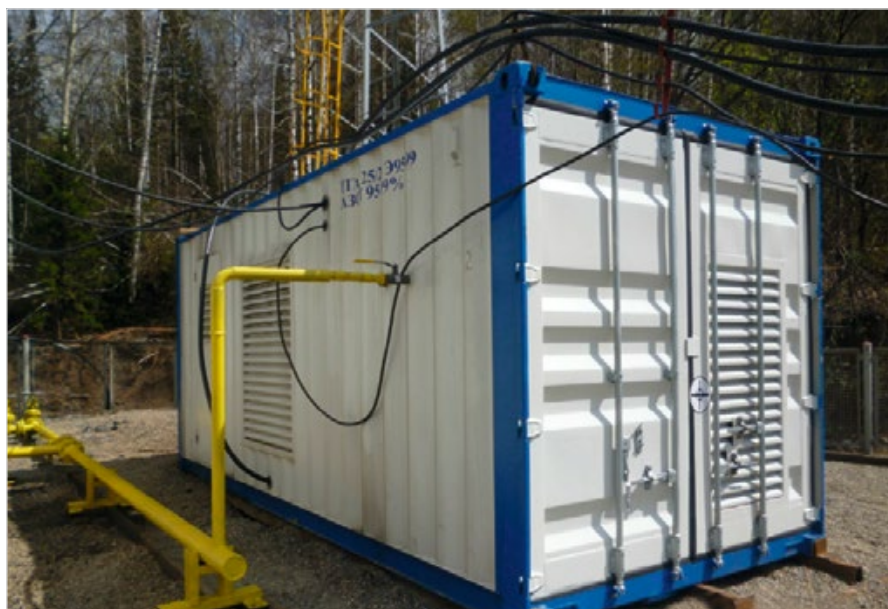
Рис. 4 — Станция ТГА в блочно-модульном исполнении
