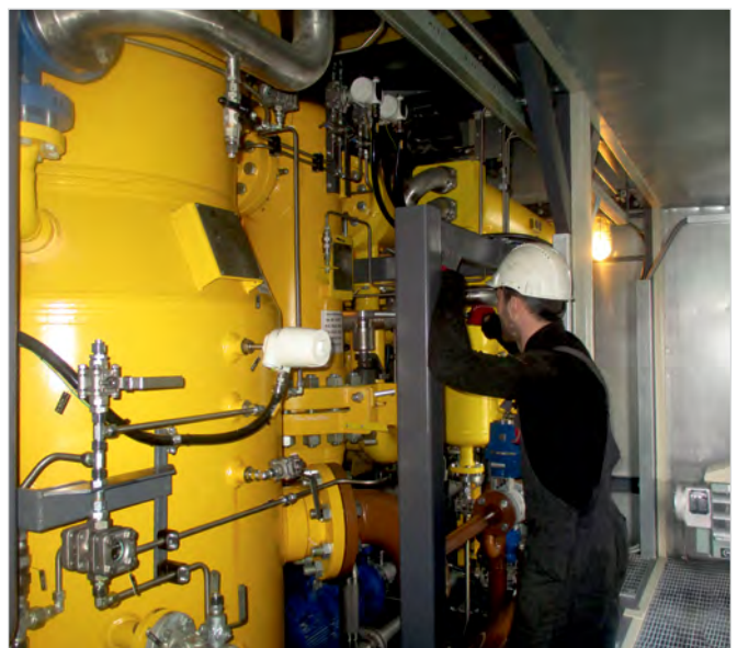
Фото 12 — Подразделение «СервисЭНЕРГАЗ-Ухта» обеспечивает бесперебойную эксплуатацию систем газоподготовки на энергоцентрах ООО «ЛУКОЙЛ-Коми»
