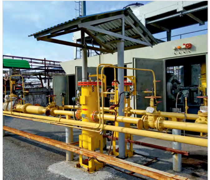
Фото 4 — В рамках технического переоснащения ГТЭС-25П в Уфе СервисЭНЕРГАЗ установил высокоэффективную систему фильтрации топливного газа
