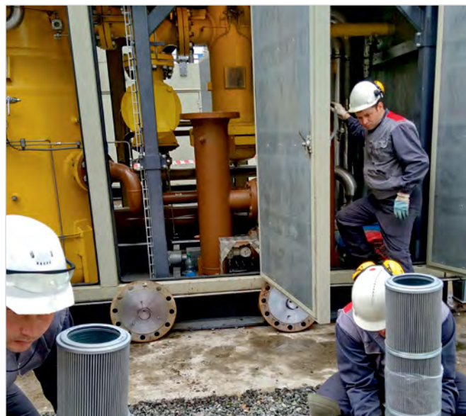
Фото 8 — Комплексное обслуживание технологических установок «ЭНЕРГАЗ» на площадке ГТУ-ТЭЦ «Восточная» во Владивостоке
