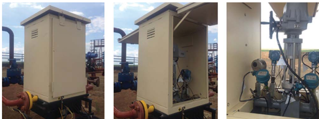
Рис. 3 — Модуль регулирования на скважине Fig. 3 — The rationing module of the well
