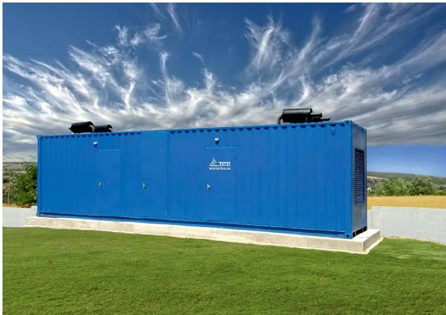
Фото 1 — Энергокомплекс 1000 кВт в блок-контейнере УБК-12 с дополнительным отсеком
