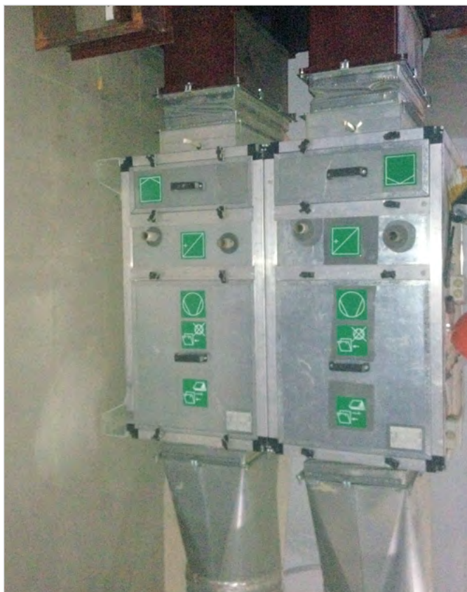
Приточно вытяжная установка цех гидрокрекинга Орскнефтеоргсинтез
