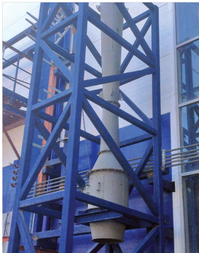
Эжектор низкого давления ЭИЗЗ цех гидрокрекинга Орскнефтеоргсинтез
