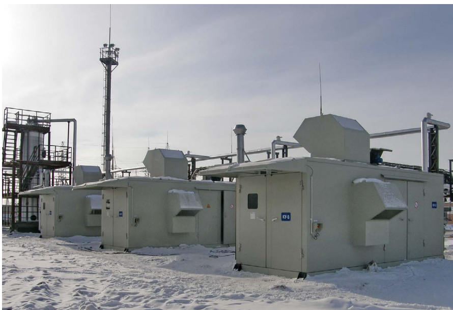
Фото 9. Газодожимное оборудование низкого давления на ДНС-2 НГДУ «Комсомольскнефть»
