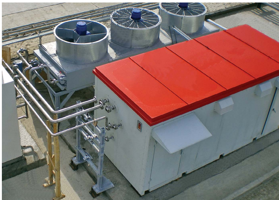
Фото 4. Адсорбционный осушитель для дополнительной осушки попутного газа на ЦПС Западно-Могутлорского месторождения ОАО «Аганнефтегазгеология»
