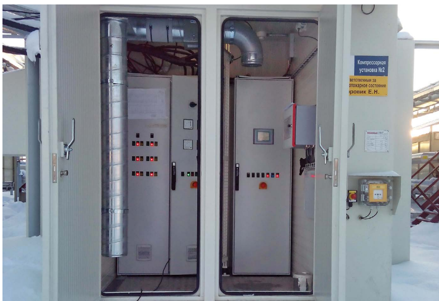
Фото 7. Отсек САУ компрессорной установки на КС Мурыянского месторождения
