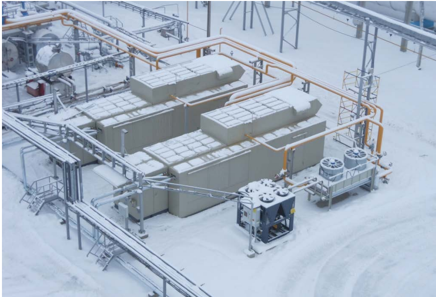
Фото 8. Компрессорная станция Речицкого месторождения («Белоруснефть») компримирует низконапорный ПНГ
