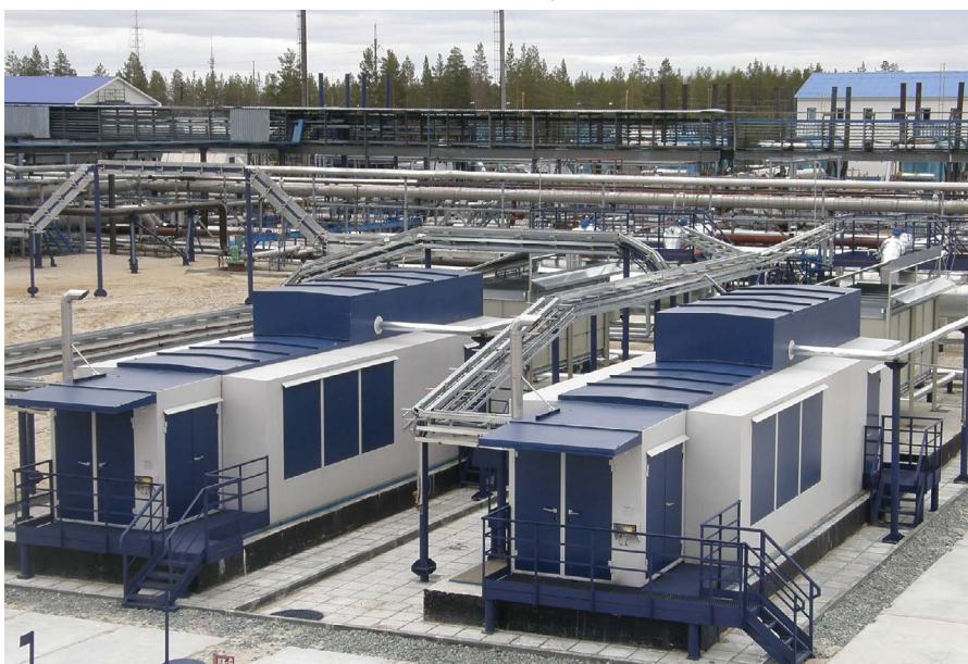
Фото 10. Вакуумные компрессорные установки «ЭНЕРГАЗ» работают на попутном газе с давлением 0,001 МПа
