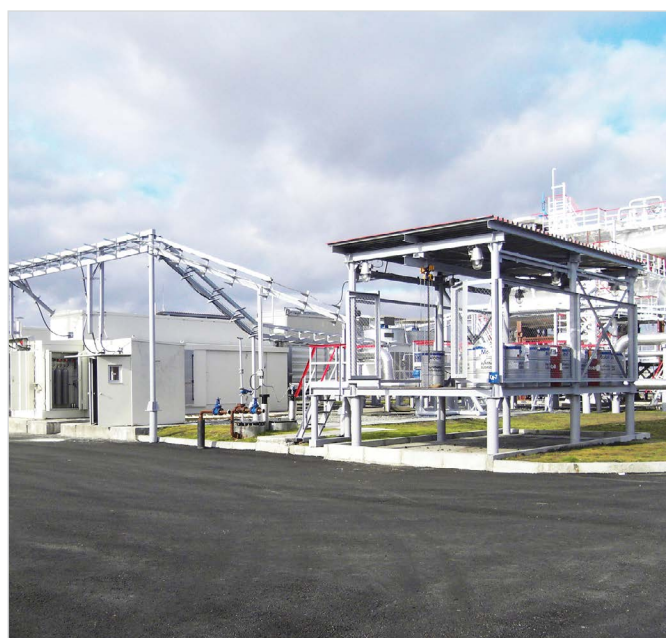
Фото 2. Битумское месторождение ОАО «Сургутнефтегаз». Компрессорная станция для компримирования низконапорного ПНГ
