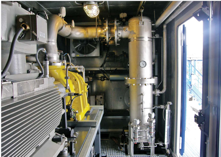
Фото 3. Фильтр-скруббер встроен в блок-модуль вакуумной компрессорной установки «ЭНЕРГАЗ» на ДНС-1 Вынгапуровского м/р ОАО «Газпромнефть-Ноябрьскнефтегаз»
