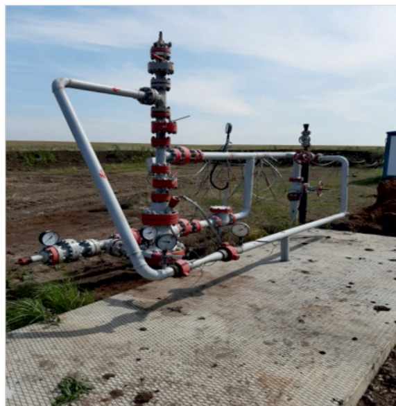
Фото 1. УСУ в устьевой обвязке скважины
