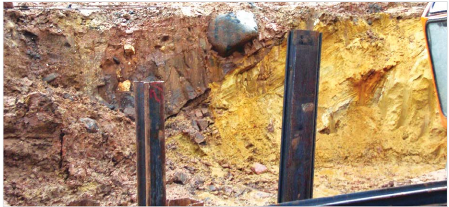
Рис. 1 — Вскрытая часть геологического разреза подводного перехода магистрального нефтепровода Сургут – Полоцк через р. Улейма в месте остановки джюкера при протаскивании
