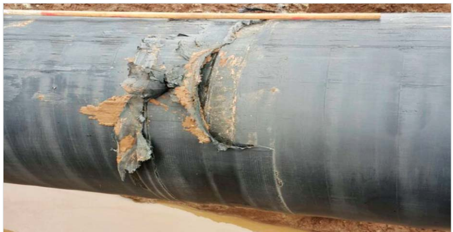
Рис. 2 — Нарушение изоляции трубопровода при нарушенной геометрии ствола скважины
