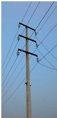
Рис. 3 — ИПВЛ и трансмиттер, установленные на ВЛ 10кВ
