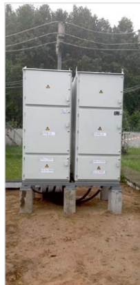
Рис. 4 — УШЗ, установленные на двухсекционном РУ 10кВ
