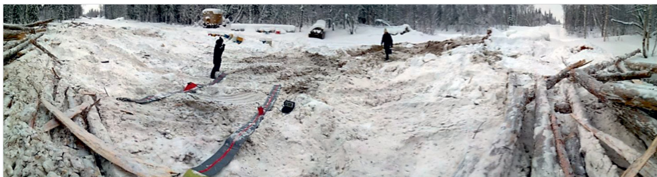
Рис. 1. Геофизическое обследование трассы ННБ Fig. 1. Geophysical survey of the underground passage route
