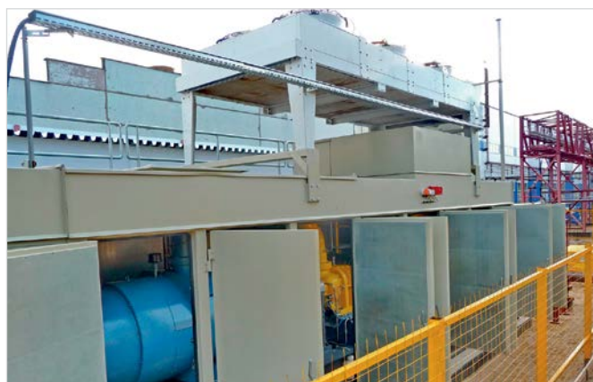
Фото 8. Установка газоподготовки «ЭНЕРГАЗ» для испытательного стенда АО «ОДК - Газовые турбины»
