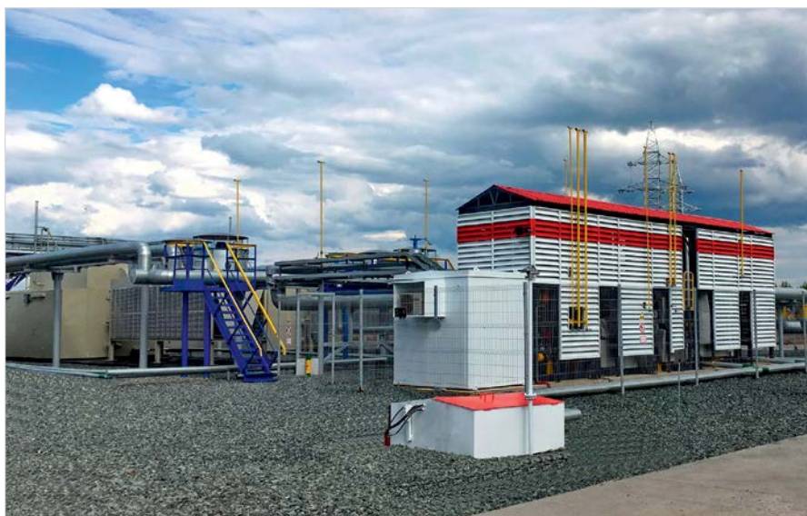
Фото 1. Система газоподготовки и газоснабжения «ЭНЕРГАЗ» для энергоцентра ООО «ЛУКОЙЛ-Кому»
