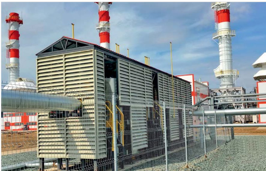
Фото 2. Блок подготовки попутного газа на Усинском месторождении
