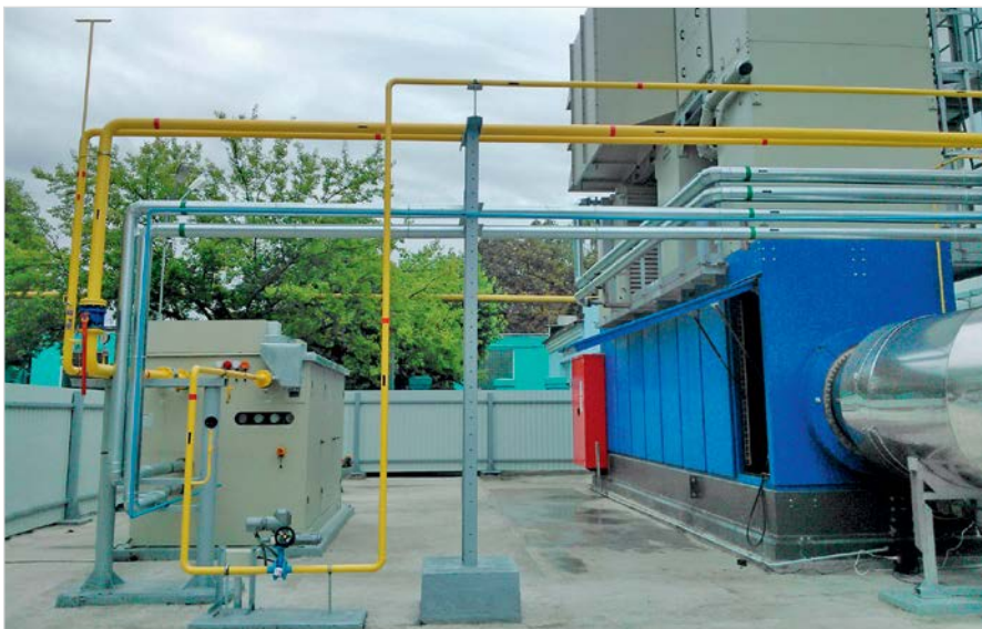
Фото 3. Малая ГКУ для ГТУ Turbomach ТВМ-С40 мощностью 3,5 МВт (энергоцентр «Минского КСИ»)
