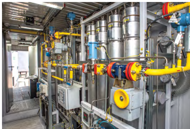
Рис. 6 — Мембранная азотная установка Заполярного НГКМ (отсек с воздуходелительными мембранными модулями)
