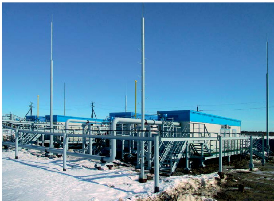
Компрессорные установки для добычи и сбора низконапорного газа на Вынгапуровском месторождении ООО «Газпром добыча Ноябрьск»
