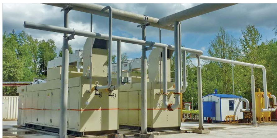
Фото 12. Система газоподготовки для автономной ГПЭС завода микроэлектроники «Ангстрем-Т»
