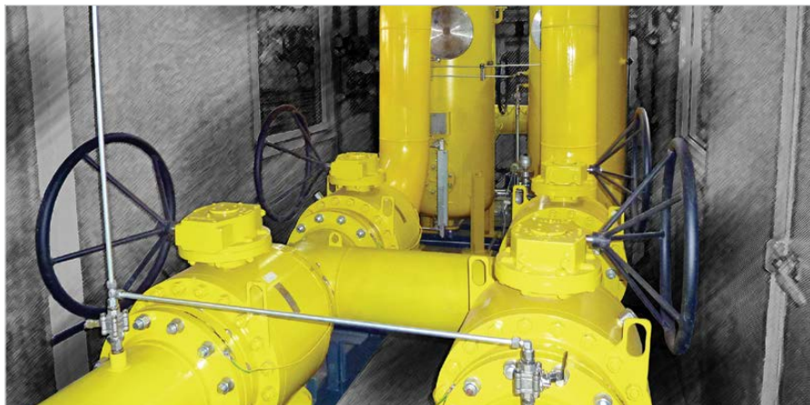
Фото 2. Технологический отсек блочного пункта подготовки газа
