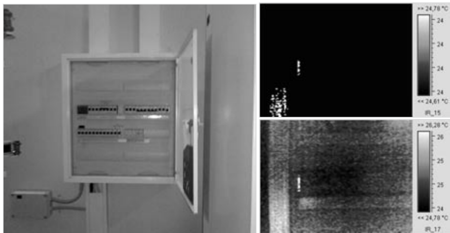
Рис. 2 — Фотография и термограммы электроавтомата
