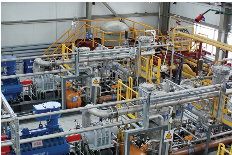
Фото 5. ДКС ангарного типа в составе ГТЭС-24 Северо-Лабатьюганского месторождения
