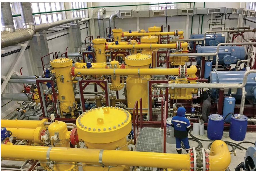
Фото 4. Установка подготовки топливного газа для ГТЭС на Мессояхе
