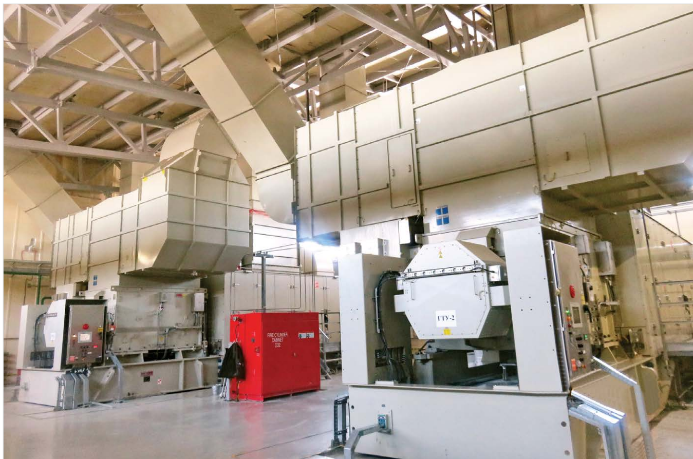
Фото 10. Газотурбинные установки Titan 130 производства Solar
