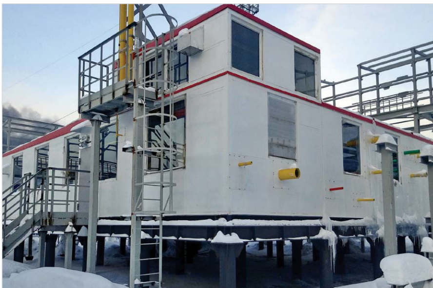
Фото 9. Модуль подготовки топливного газа №1 для объектов УКПГиК на Восточном Уренгое
