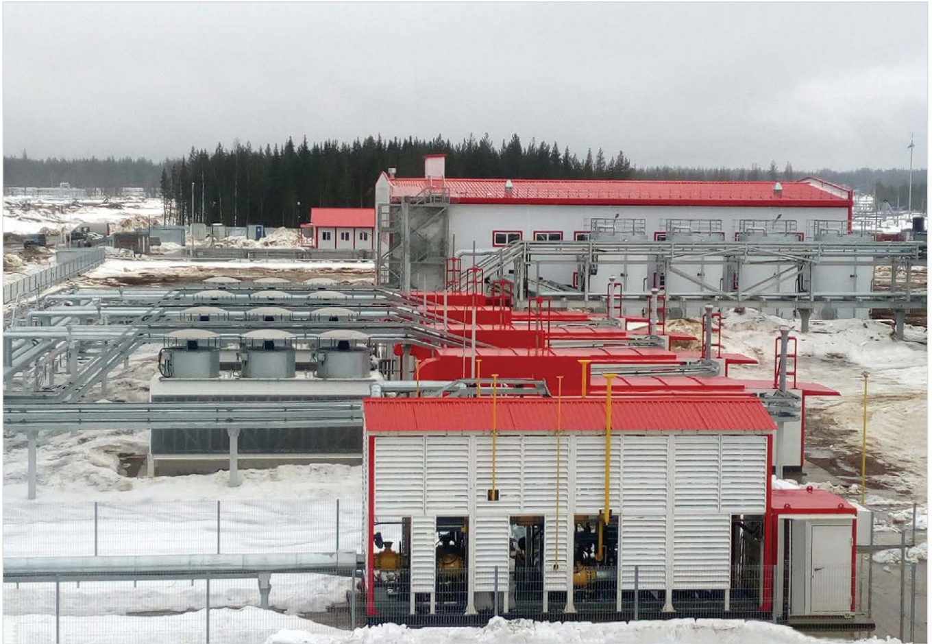
Фото 8. Система газоподготовки «ЭНЕРГАЗ» на Ярегском нефтетитановом месторождении
