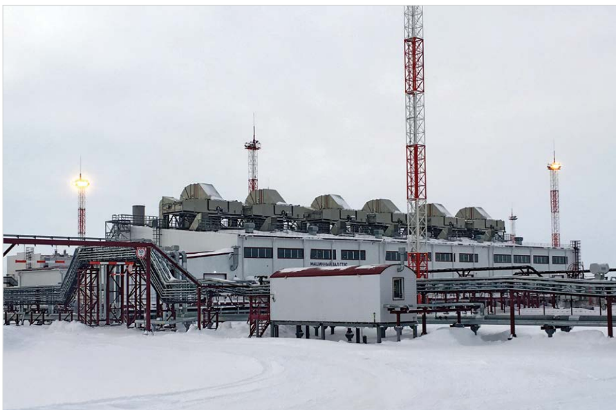
Фото 3. Восточно-Мессояхская – самая северная материковая газотурбинная электростанция в России
