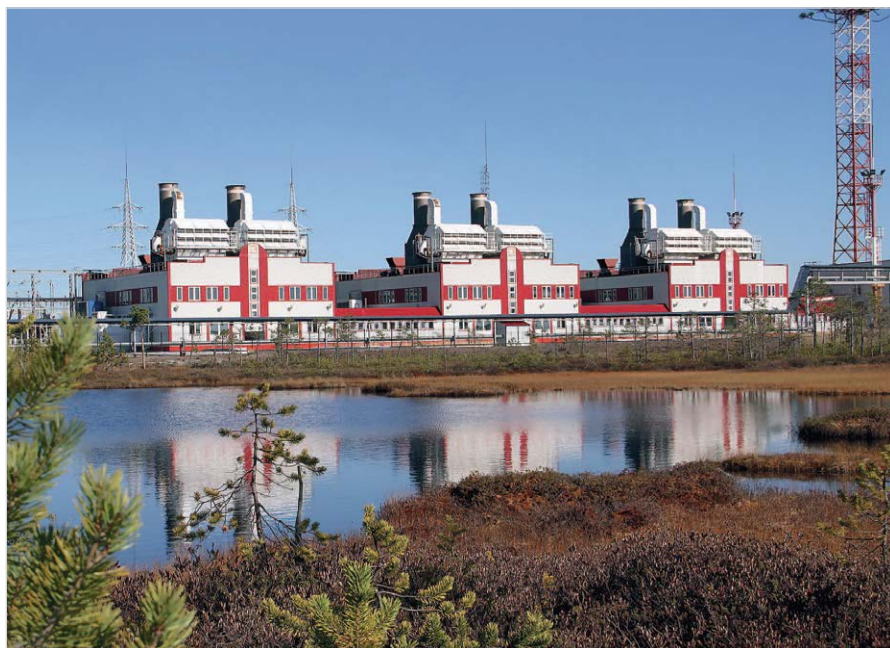
Фото 1. ГТЭС Ватьеганского месторождения работает на попутном газе
