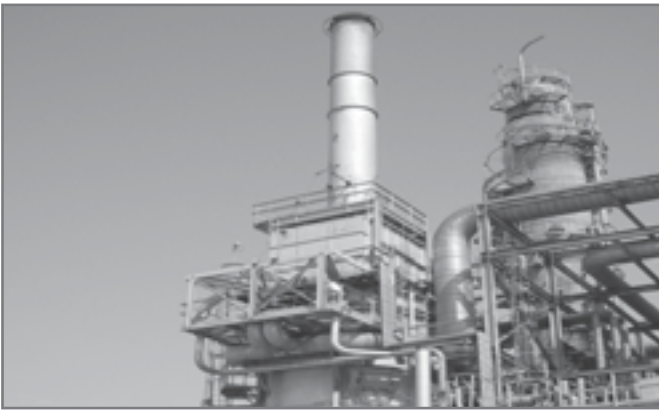
Рис 2. Установка первичной перегонки нефти ЭЛОУ – АВТ 2
