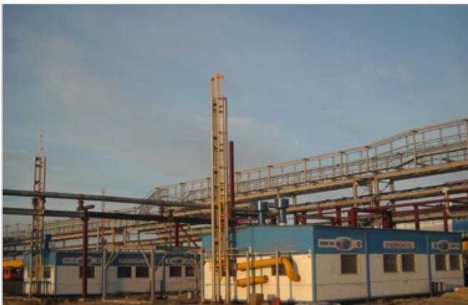
Рис. 3 — БППГ — Блочный пункт подготовки газа на Южно-Уральской ГРЭС-2
