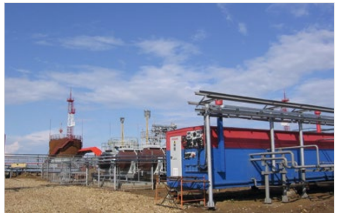
Рис. 4 — БППГ — Блочный пункт подготовки газа на месторождении в Саратовской области
