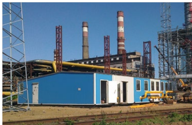
Рис. 2 — БППГ — Блочный пункт подготовки газа в Кировской области
