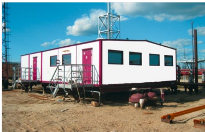
Рис. 1 — БППГ — Блочный пункт подготовки газа на месторождении в ЯНАО
