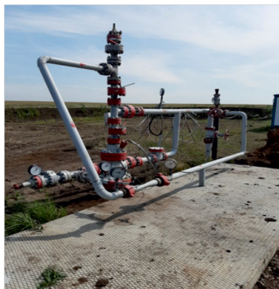
Фото 1. УСУ в устьевой обвязке скважины
