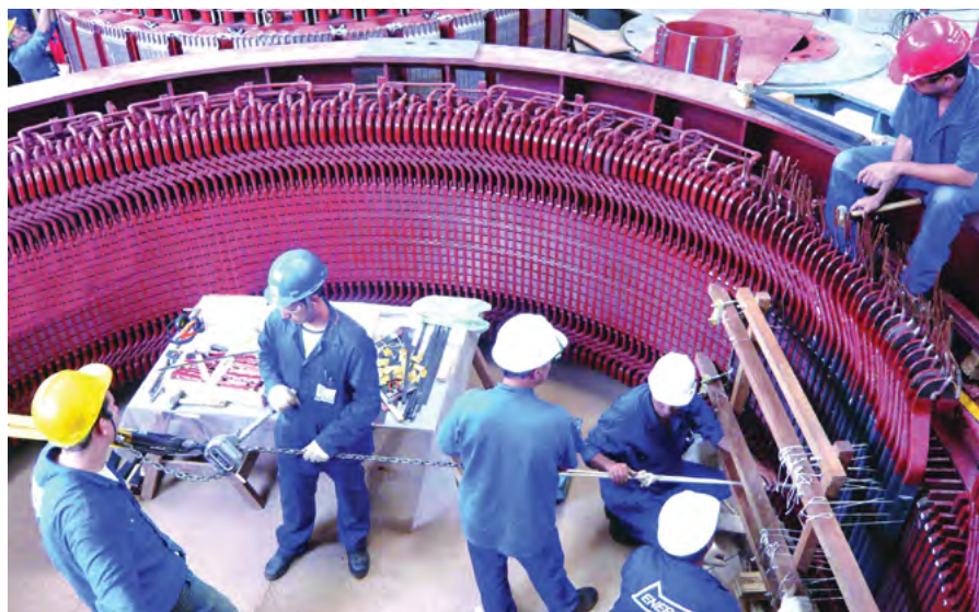
Фото 1. Укладка катушек стыковой зоны статора гидрогенератора «Русэлпром» (для ГЭС «Новая Аврора», Бразилия)
