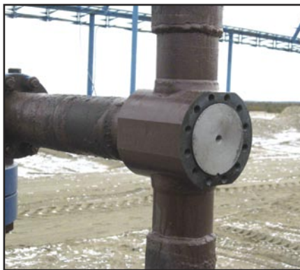
Рис. 3. Клапан КОНЗ на нефтяной скважине №11343 месторождения «Приобское». Задняя крышка клапана снята
