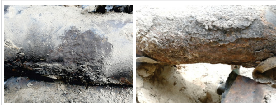
Фото 2. Часть дефектов на вскрытом интервале Photo 2. Some defects on the opened interval
