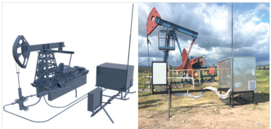
Рис. 2. Комплекс оборудования по отбору газа из скважин
