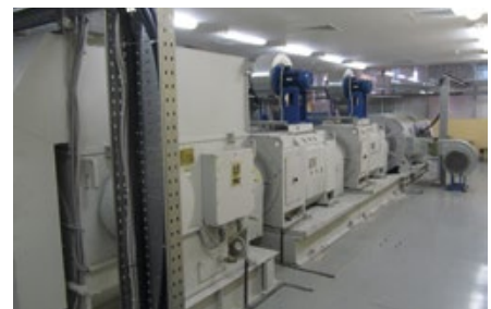
Рис. 2 — Нагрузочный агрегат для испытания высоковольтных преобразователей частоты в цеху ЗАО «ЧЭАЗ»
