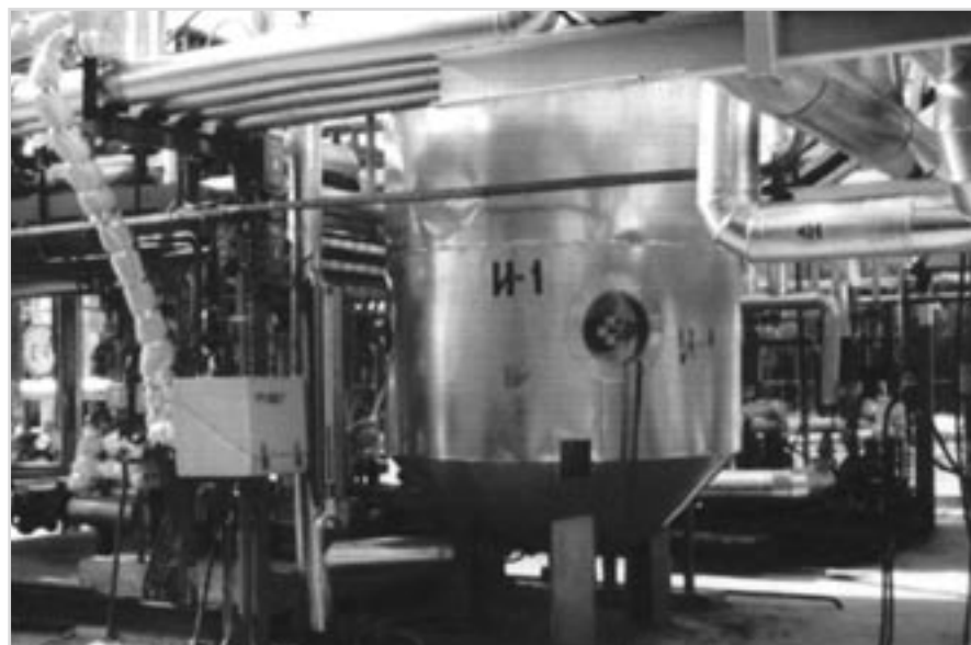
Фото 1. Блок УГПМ на Кондинском НПЗ
