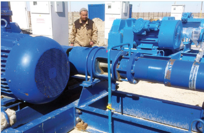
Рис. 2 — Мультифазные винтовые насосные установки У1НВ1-240.3.04.1500 в Казахстане
