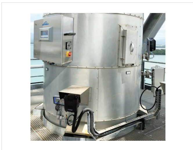
Рис. 2. Система автоматического контроля промышленных выбросов
