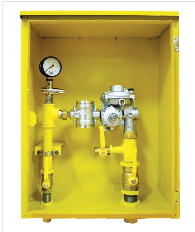
Рис. 14 — Домовый ГРП с регулятором давления РС-10 КД и фильтром ФН
