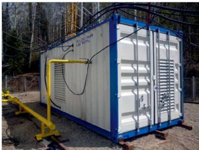
Блочно-модульная станция на объекте
