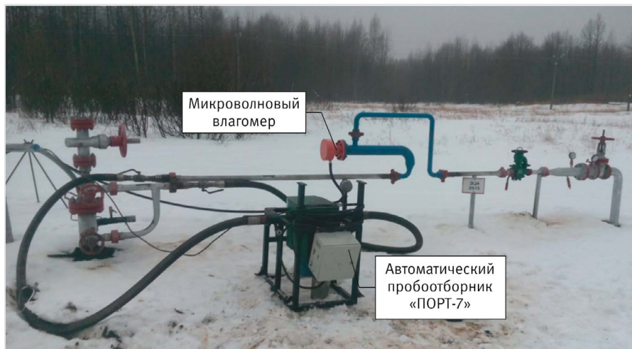
Рис. 4 — Монтаж разработанного влагомера и автоматического пробоотборника «ПОРТ-7» на устье скважины при проведении ОПИ
