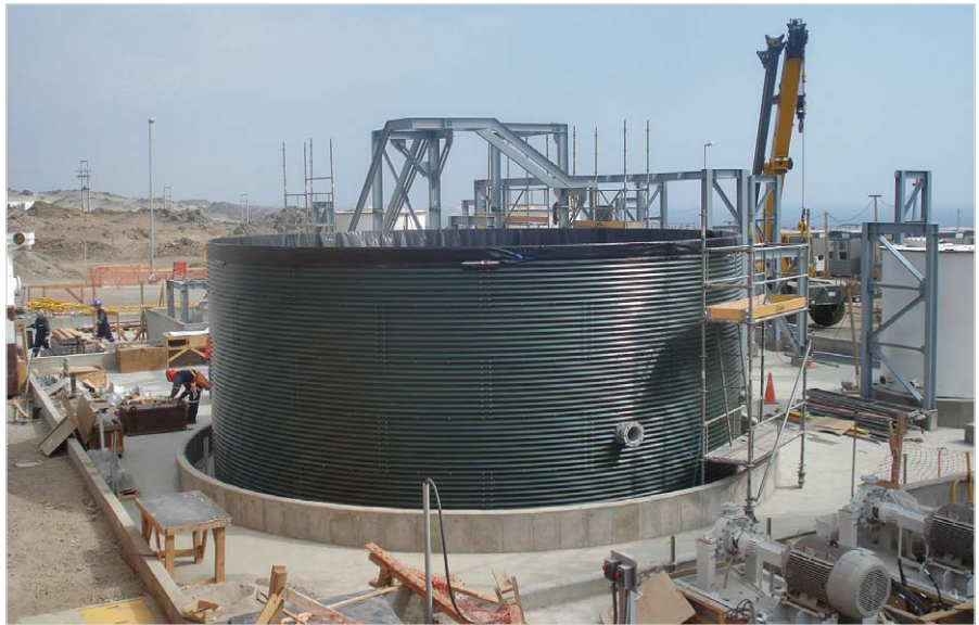
Гибридный резервуар на объекте
