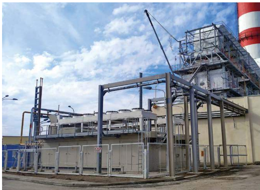
Фото 5. Оборудование газоподготовки для модернизированной Могилевской ТЭЦ-1
