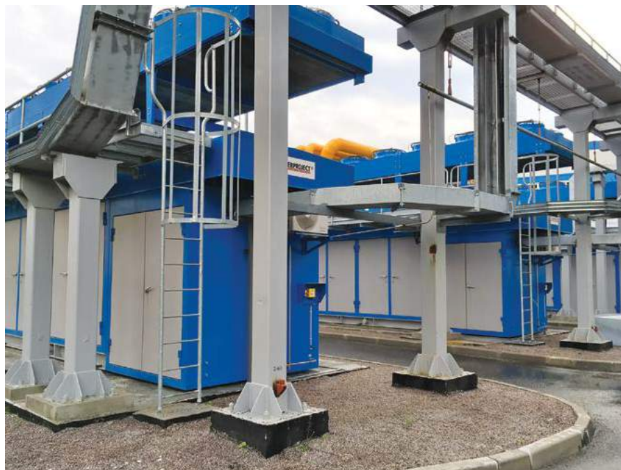
Фото 1. ДКС топливного газа для ГТУ-ТЭЦ Центральной ТЭЦ Санкт-Петербурга
