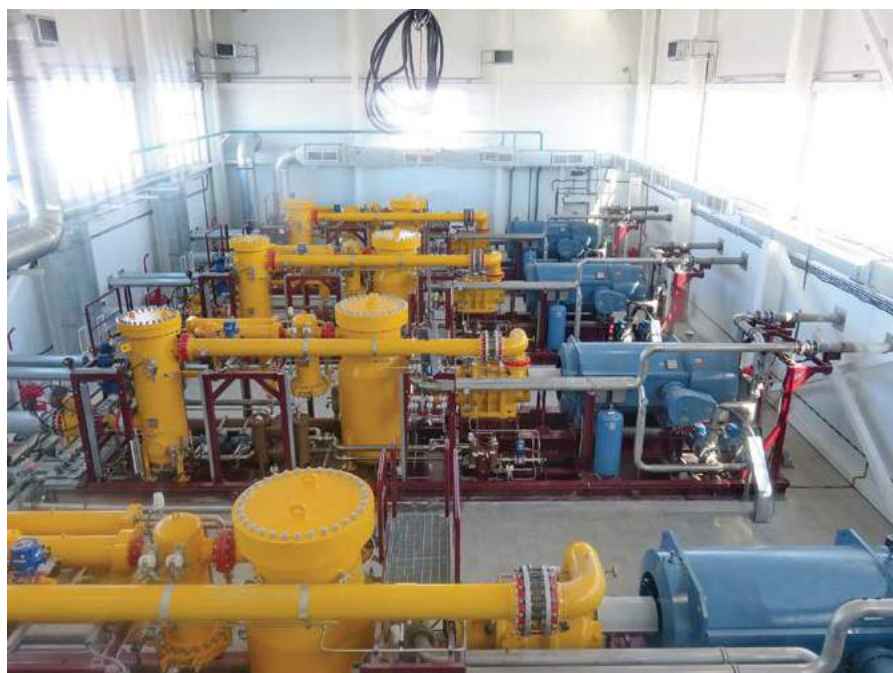
Фото 2. Установка подготовки топливного газа для ГТЭС Восточно-Мессояхского месторождения
