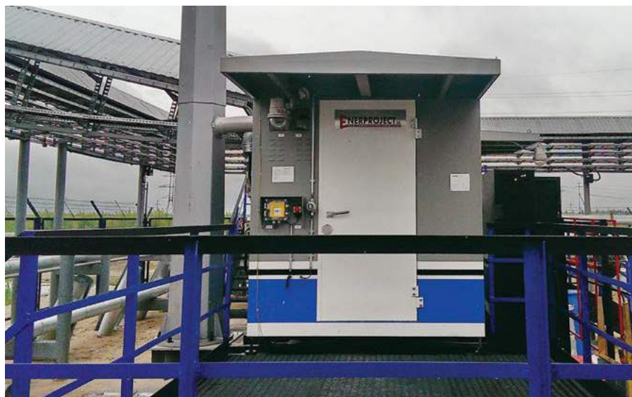
Фото 4. Вакуумная компрессорная станция «ЭНЕРГАЗ»
