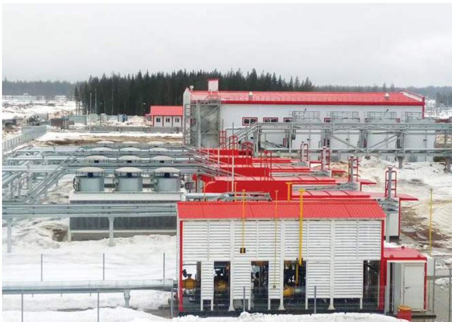
Фото 8. Система газоподготовки и газоснабжения энергоцентра «Ярега»
